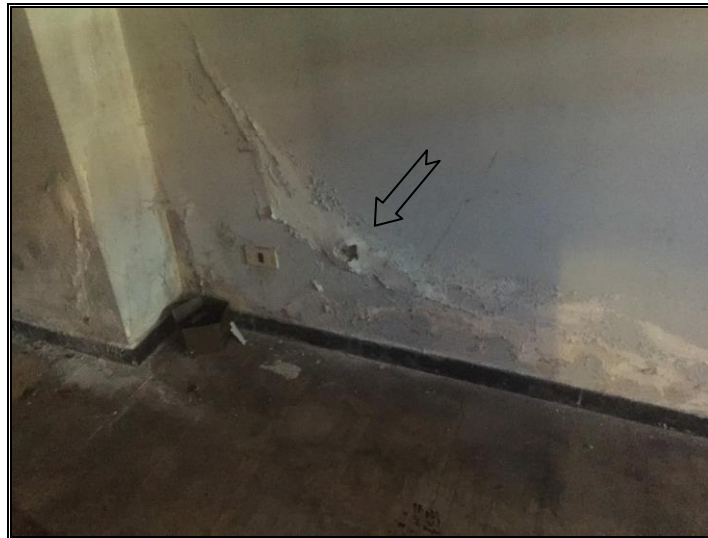
Foto n°3 – tracce di umidità sulle pareti del locale box
